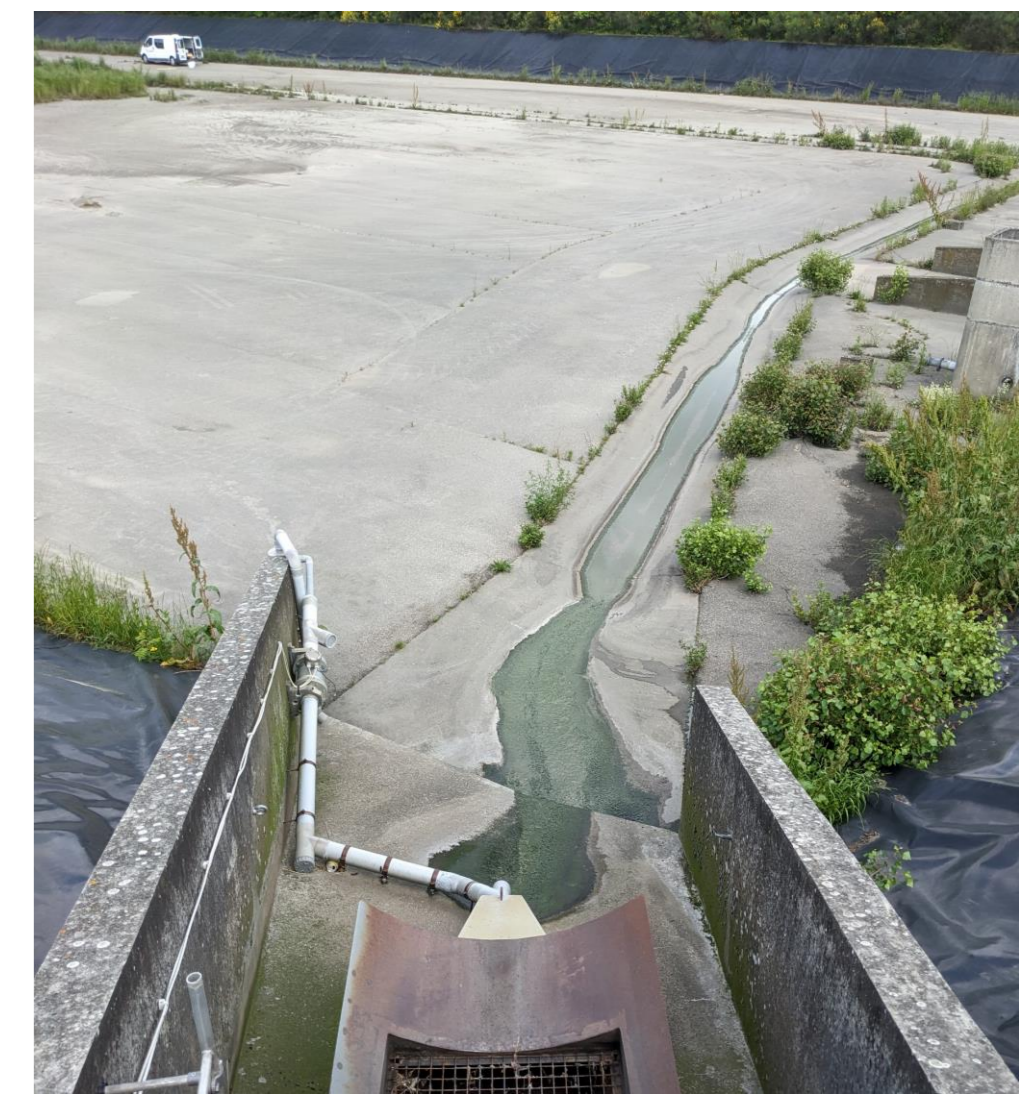
Bassin de rétention Django
